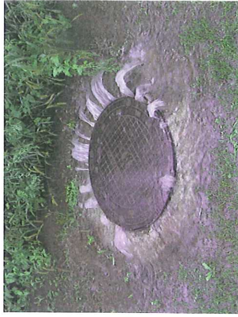
Beispiel für Überlastung der Kanalisation
